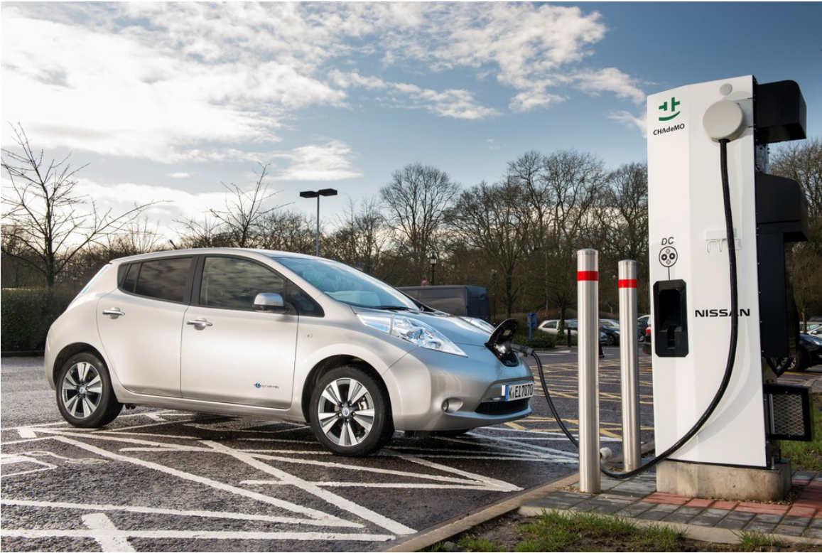
Schnellladestationen nach CHAdeMO-Standard.
